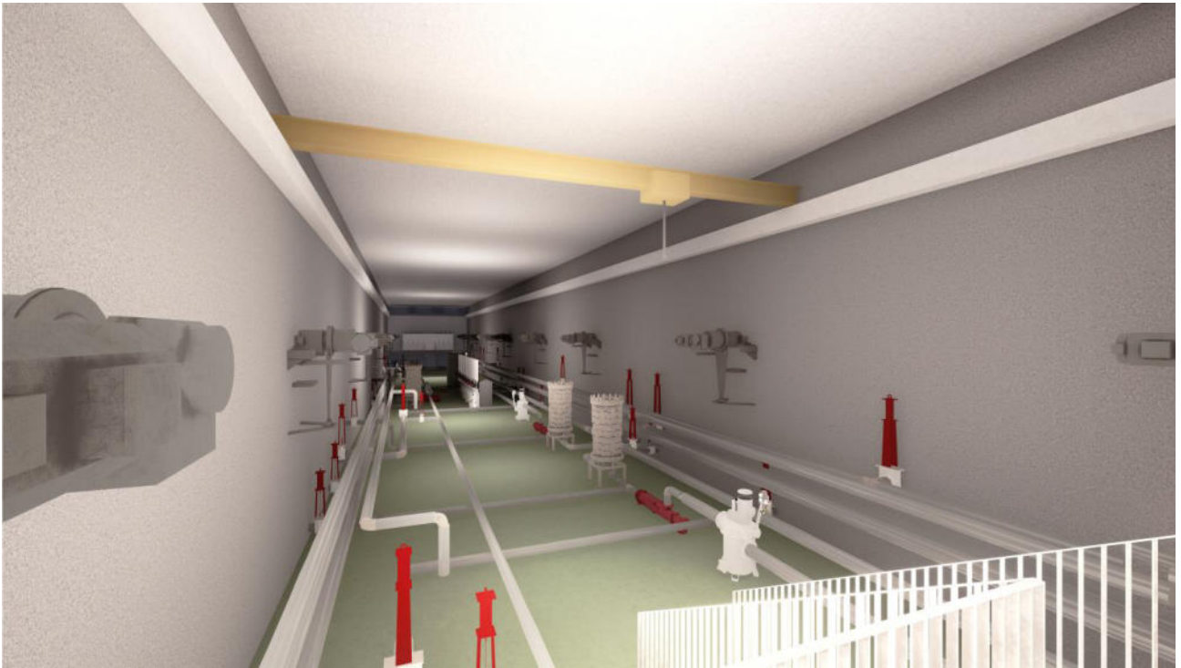
Abb. 6 Einblick in den Pumpenraum der Fermenter und Nachfermenter
